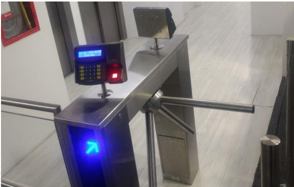
IN-2 sobre Pedestal Metálico
